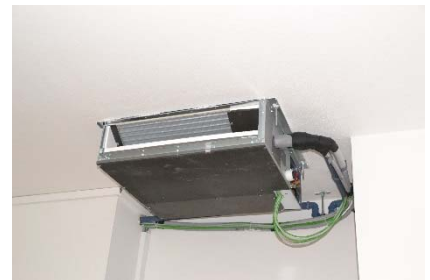
Installierte Innengeräte vor der Verkleidung
